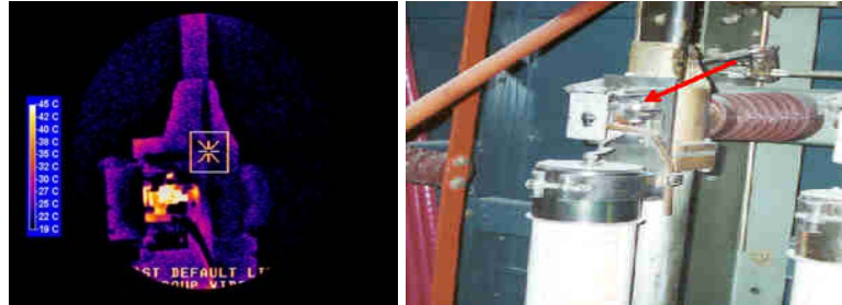
En tableros de alta tensión
